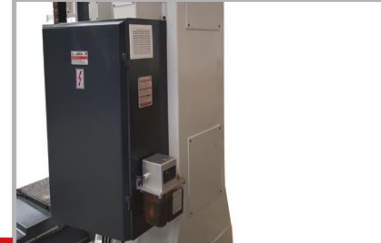
Elektrik panosu soğutma ve havalandır- ma sistemi Electric panel fan and venti- lating system
